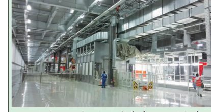
工程名称:一汽-大众汽车有限公司长春工厂一厂结构更新项目一期涂装车间施工
